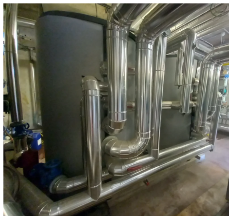
Serbatoi inerziali destratificati
